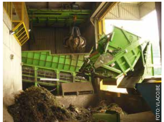
▲ Stortbunker voor gft-afval.
