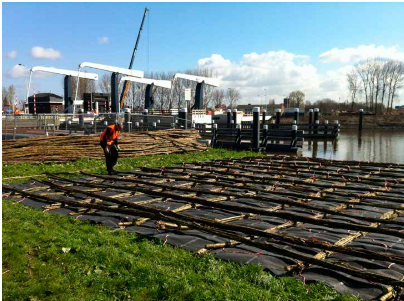
Zinkstuk voor de Hollandse IJssel bij de nieuwe Julianasluis in Gouda. Dit is bedoeld om de bodem onder water te beschermen tegen stromingen en erosie. (foto: Wikipedia)
